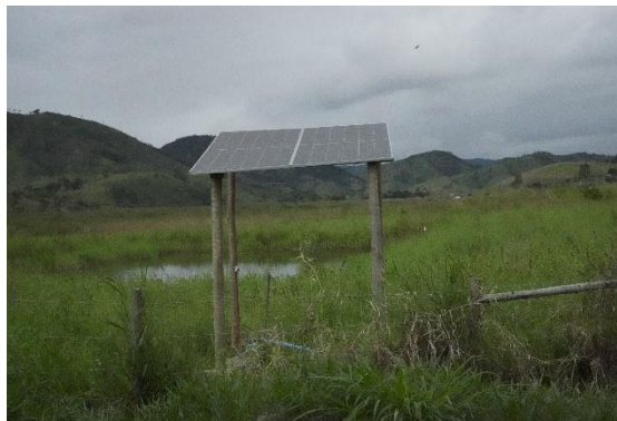
Figura 77: Bomba d'água movida a energia solar.
